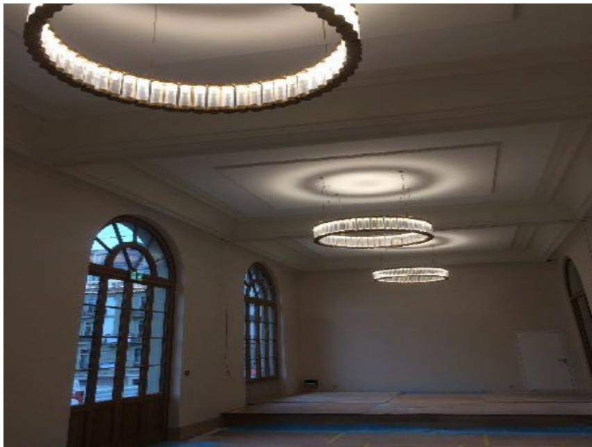
Pose luminaire salle polyvalente
